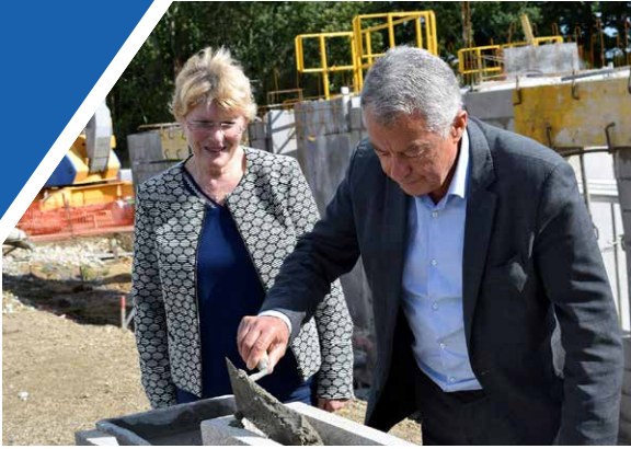
SEPTEMBRE Pose de la 1 re pierre du nouveau lotissement OPAC de Kersalomon (12 maisons en accession, 30 logements locatifs et 22 lots libres) en présence de M. André Fidelin, Maire de Concarneau et de Mme Marie-Christine Coustans, Présidente de l'OPAC.
