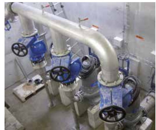
L'impressionnant système de pompage dans un poste de refoulement situé sous la place Suffren
