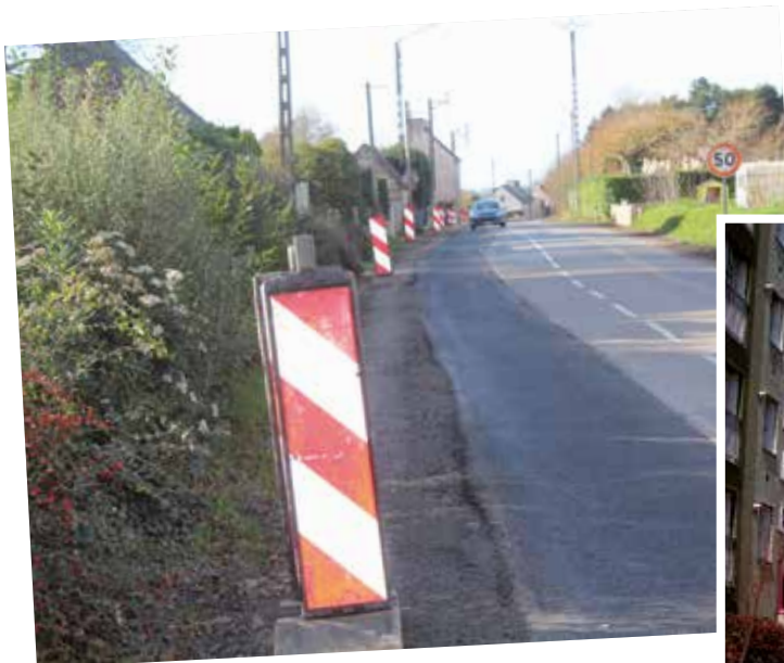
Croissant-Bouillet : les travaux de sécurisation complet de la voirie ont débuté en décembre
